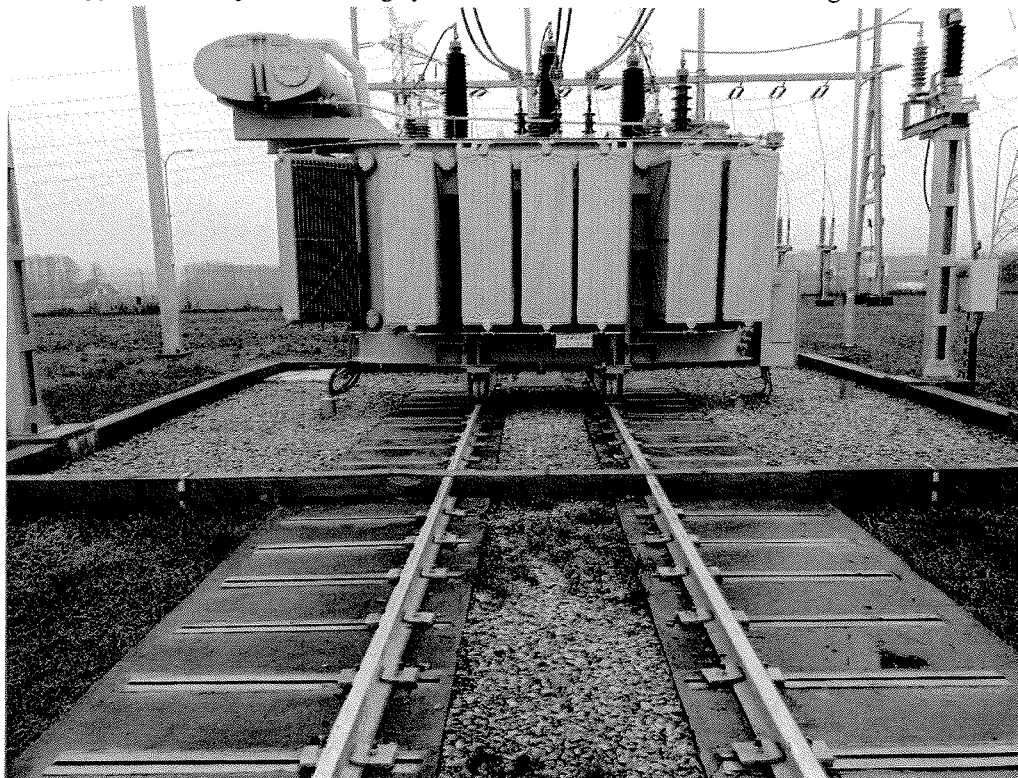
Zdjęcie nr 2. Stacja Elektroenergetyczna 110/15 kV RPZ Kolno – widok fragmentu obiektu
