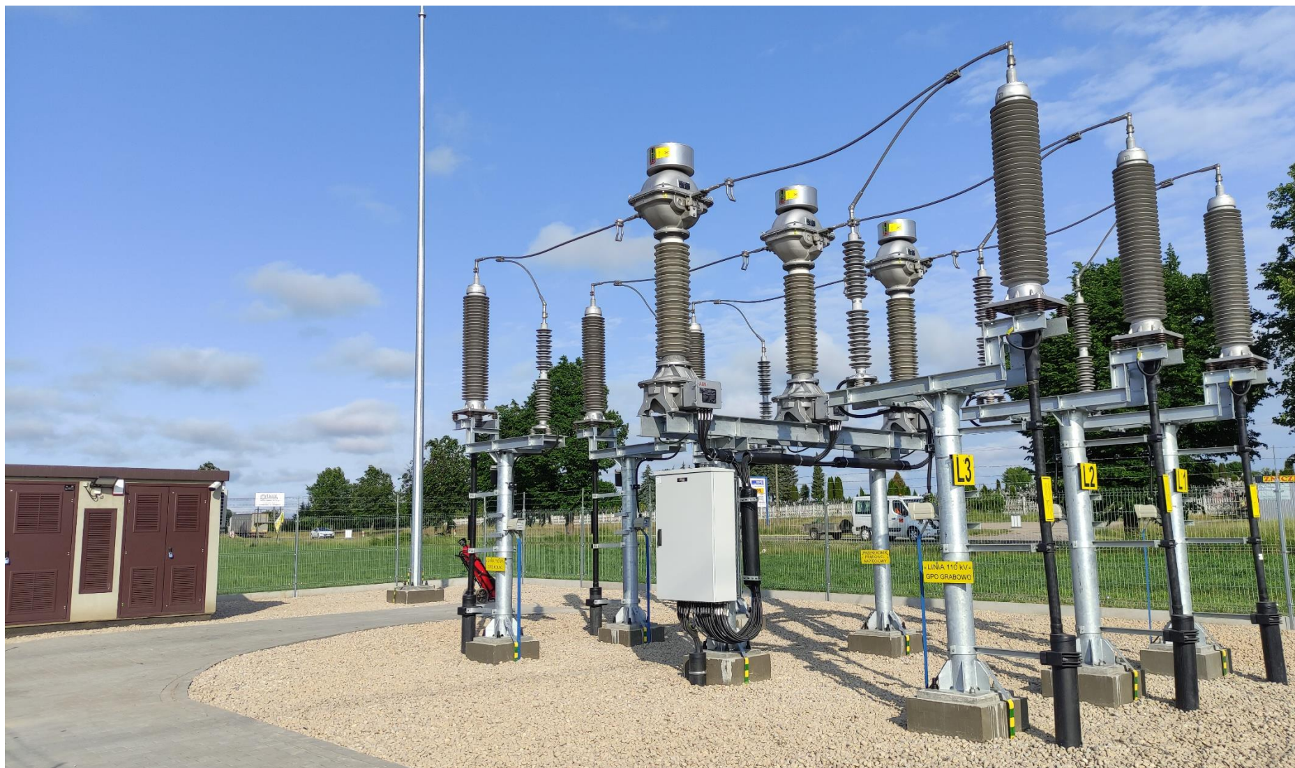
Zdjęcie nr 1. Bramka pomiarowa 110 kV dla obsługi FW Grabowo.
